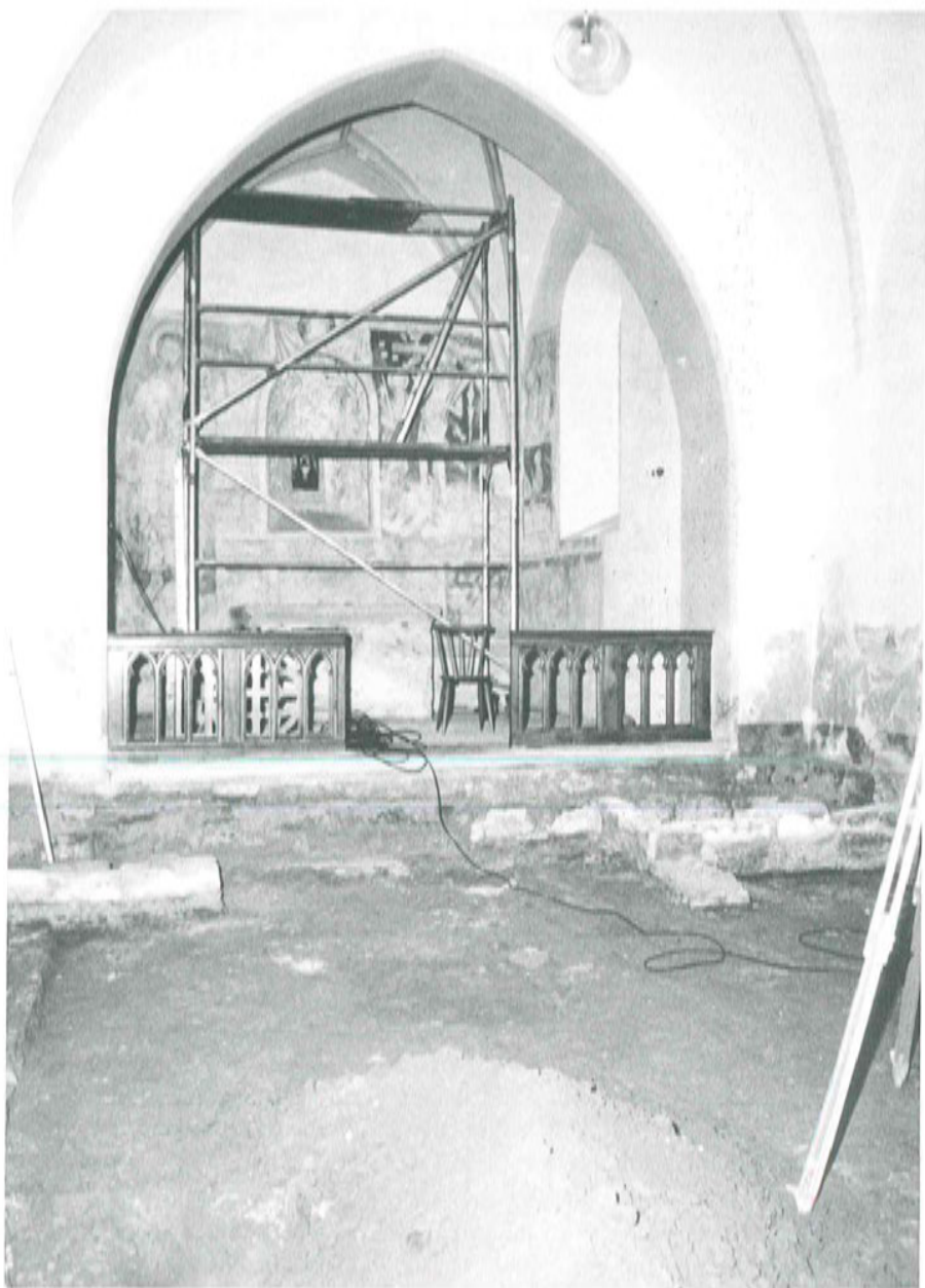
Abb. 14; Bergham. Blick auf den Altarraum während der Untersuchung des Langhauses. Rechts vor dem Chorbogen die Substruktion eines spätmittelalterlichen Seitenaltares, links Rest eines neuzeitlichen (barocken) Altarunterbaues aus Ziegeln.
