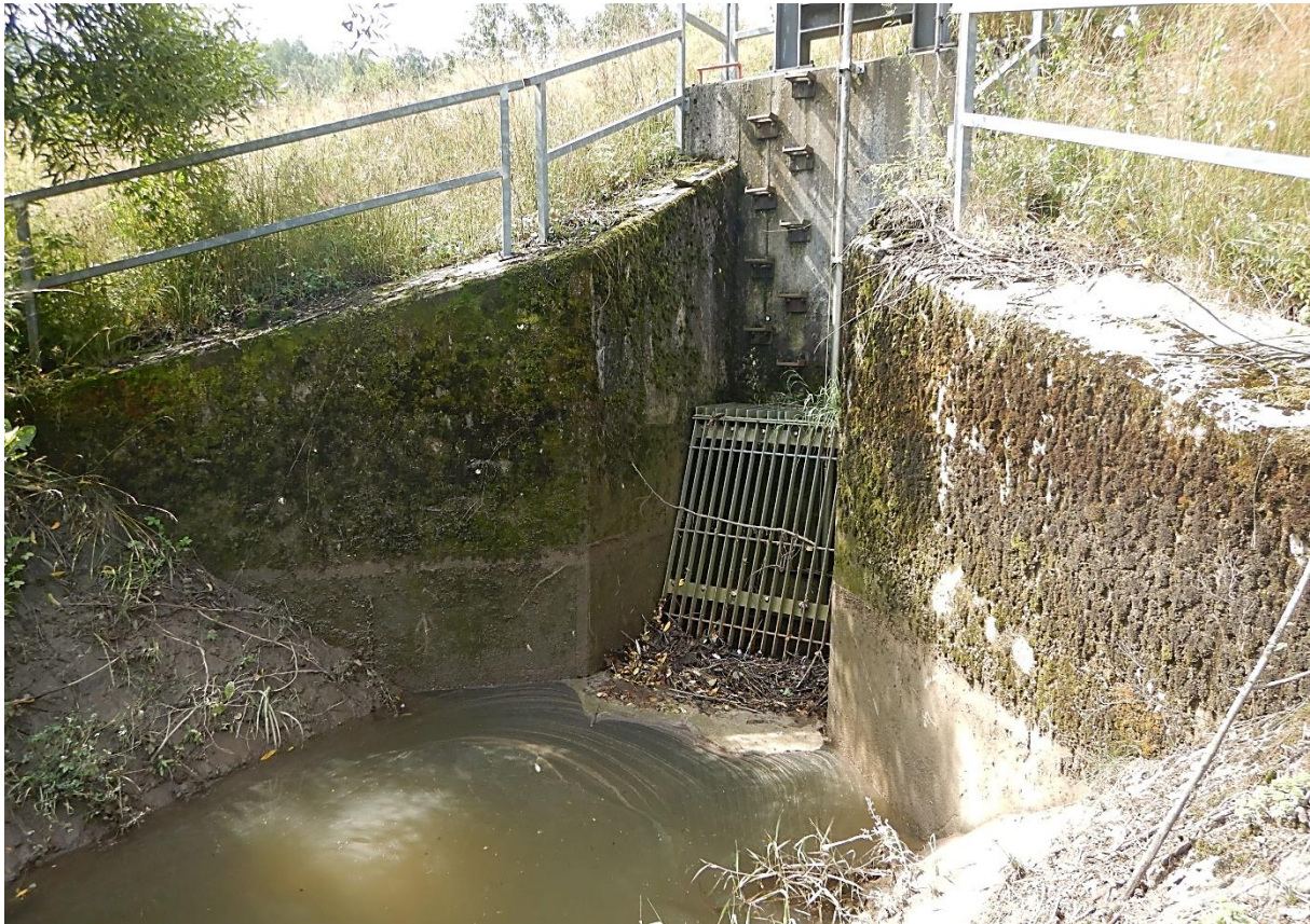
Abbildung 5.6: Einlaufbauwerk HRB Aubach mit Blick auf den Rechen
