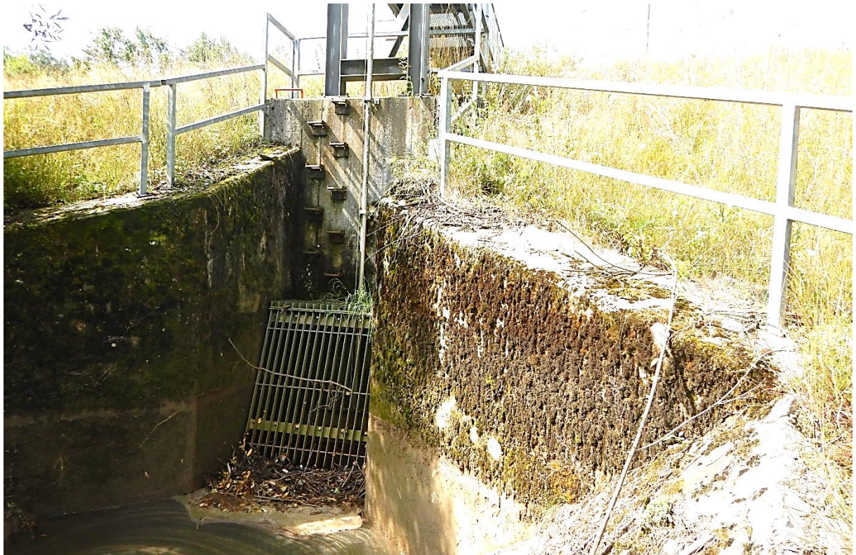
Abbildung 4.3: Blick auf das Einlaufbauwerk mit Rechen und Schieber
