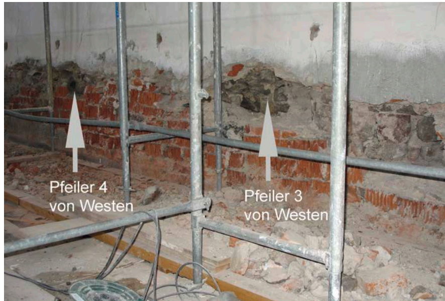
Abb. 6: Künzing-St. Laurentius. Im Zuge der Innenrenovierung vorgenommene partielle Eingriffe an der Südwand mit Hinweisen auf zwei Rundpfeiler. (Foto: Schmotz 22.8.2007)
