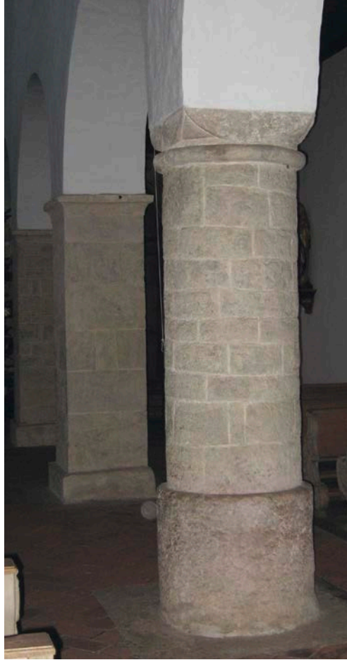
Abb. 24: Petersberg bei Erdweg, Lkr. Dachau. Südlicher Rundpfeiler des einmaligen Stützenwechsels aus Werksteinen unterschiedlicher Höhe auf verbreiterem unteren monolithischen Teil. Das Pendant auf der Nordseite zeigt dagegen über der verbreiterten Basis einen Wulstring. Die Arkaden zur Obergadenwand stützen sich auf monolithische Kämpfer, in der Breite angepasst an die quadratischen Pfeiler.
