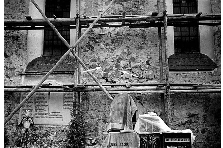
Abb. 32: Künzing-St. Laurentius. Detail der verputzfreien Nordwand mit zwei Arkadenansätzen (Pfeile). Nach der Entfernung des Seitenschiffs wurden hier wahrscheinlich Kämpfer und Rundpfeiler abgearbeitet, um eine gerade Wand herzustellen.
