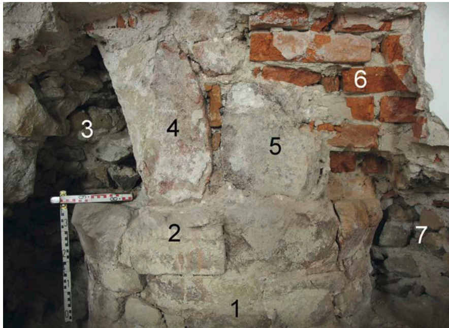
Abb. 8: Künzing-St. Laurentius. Detail des geöffneten Kämpferbereichs. 1 Pfeilerschaft; 2 Kämpferzone; 3 mit Abbruchmaterial vermauerte östliche Arkade; 4 östlicher Arkadenansatz (Werkstein); 5 westlicher Arkadenansatz (Werkstein, abgeschlagen); 6 mit Ziegeln zugesetztes Barockfenster; 7 mit Abbruchmaterial vermauerte westliche Arkade. (Foto: Schmotz 29.8.2007)
