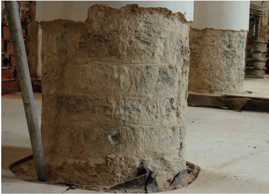
Abb. 26: Regensburg-St. Leonhard. Unter dem im Bereich der Sockelzonen abgeschlagenen Putz der Rundpfeiler zeigen sich aus Segmenten zusammengesetzte Säulentrommeln.
