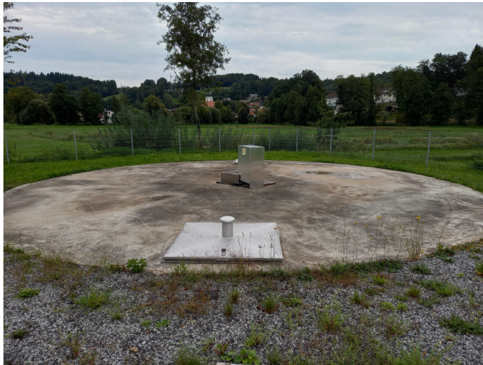
Abbildung 6: Nachklärbecken Baujahr 2017 (Stand: September 2025)
