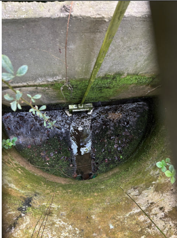
Abb. 3: Drosselschacht mit Überlaufschwelle und Drosselschieber
